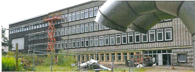
An der ehemaligen PH an der Henri-Dunant-Straße in Essen - Rüttenscheid ist am Montag, 08.08.2016 mit der Entsorgung von Asbest begonnen worden. Foto: Ulrich von Born
